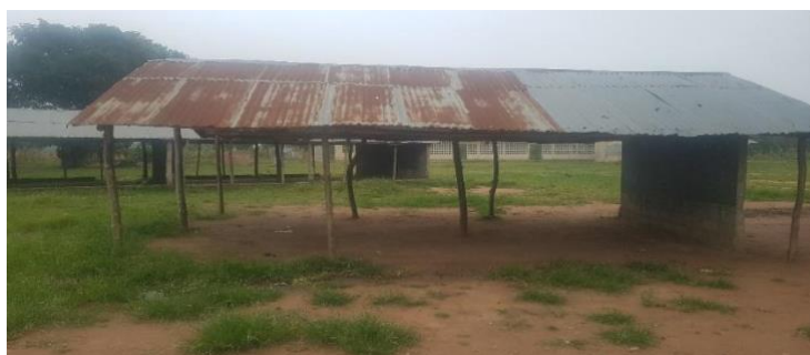
Exemple de l'état de vétusté d'une salle de classe
